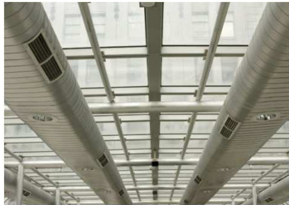
IMPIANTI MECCANICI ED ELETTRICI
