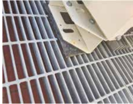
Foto 6 – Dettaglio grigliato di supporto impianti
