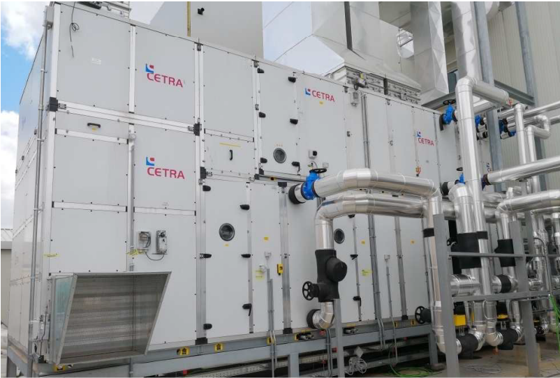
Fig.1 – Unità di trattamento aria a servizio di reparti infialamento – Distretto Chimico-Farmaceutico Anagni (FR). La centrale ha lo scopo di mantenere stabili le condizioni termoigrometriche, di sovrappressione e purezza dell'aria ambiente. Foto: Cetra S.r.l.
