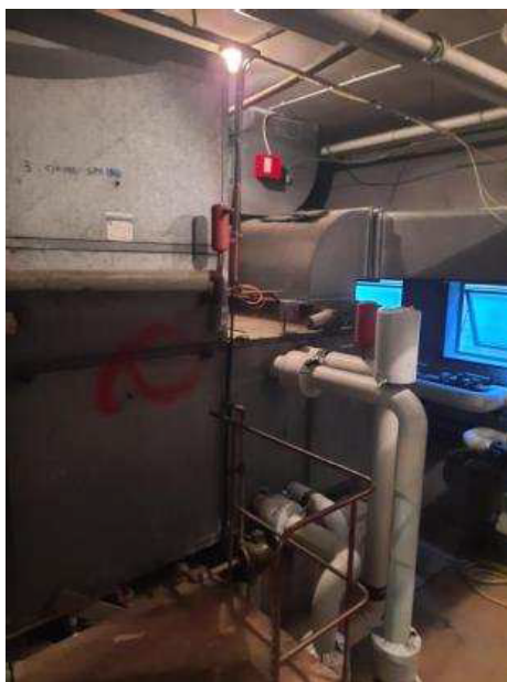
Fig.30 - Centrale di trattamento aria monoblocco installata internamente al padiglione
