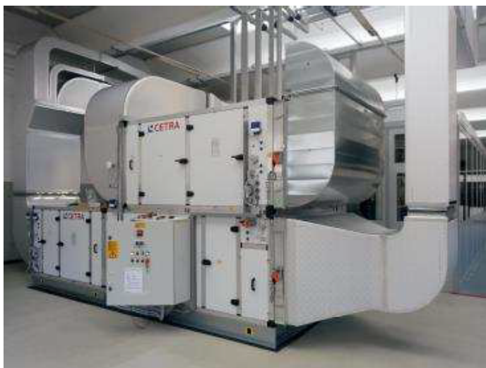
Fig.6 - UTA al servizio di una camera bianca robotizzata (2 operatori massimo) per la lavorazione di componenti elettronici – Provincia di Treviso.
