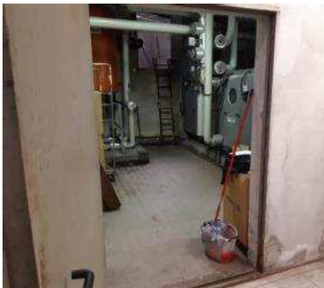
Fig. 27 - Accesso al locale UTA
