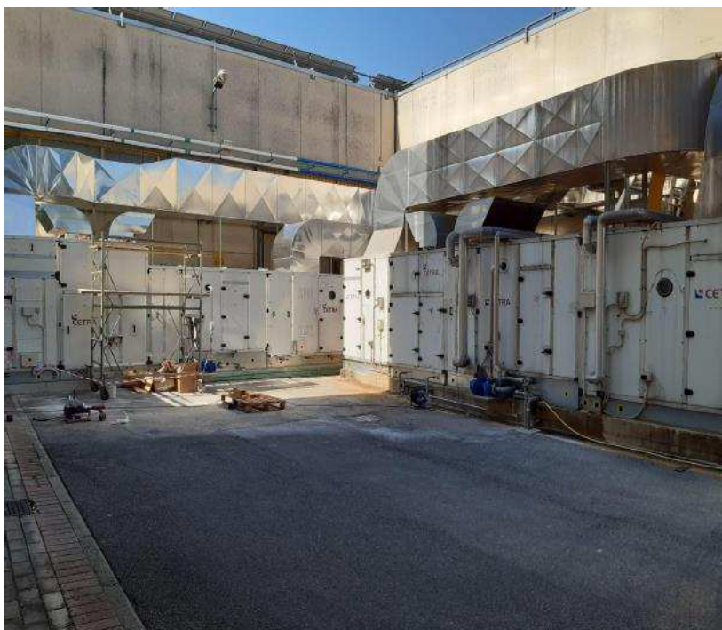
Fig.8 – UTA a servizio di camere di fermentazione tabacco. L'elevata produzione di ammoniaca da parte del processo impone vincoli costruttivi, limitando l'efficienza energetica delle unità di trattamento aria. Il processo industriale fa da padrone.
