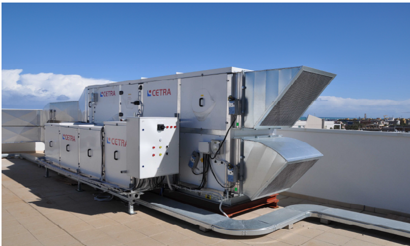
Fig.2 – Unità di trattamento aria primaria a servizio di una RSA. Foto: Cetra S.r.l.
