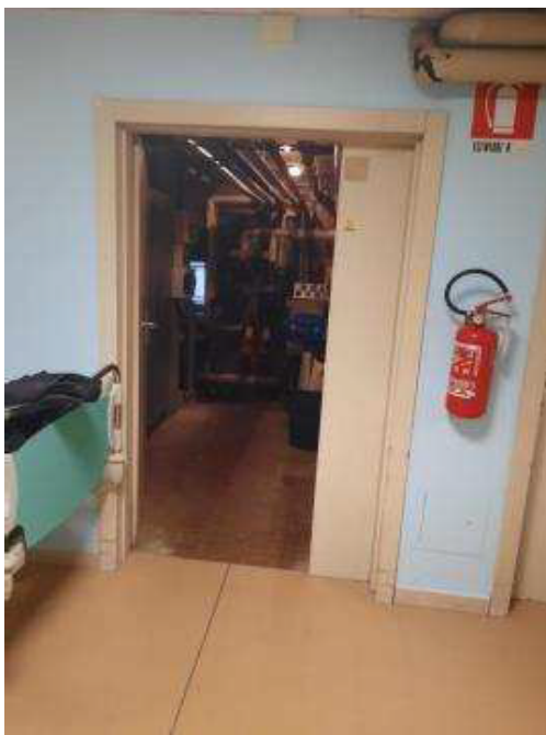
Fig. 29 - Centrale di trattamento aria da sostituire – gli spazi di accesso limitati pongono dei limiti al retrofit.
