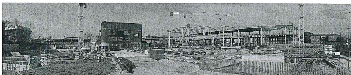
Ferrari S.p.A (Maranello): Collaudo statico del Nuovo fabbricato industriale sede della nuova Gestione Sportiva della Ferrari SpA
