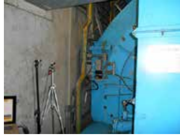
Figura 4.2 – Alternatore collegato alla turbina a gas
