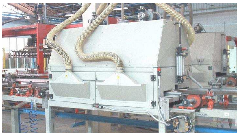
Apparecchiatura multispazzola chiusa, con aspirazione localizzata, per la "lucidatura" delle piastrelle.
