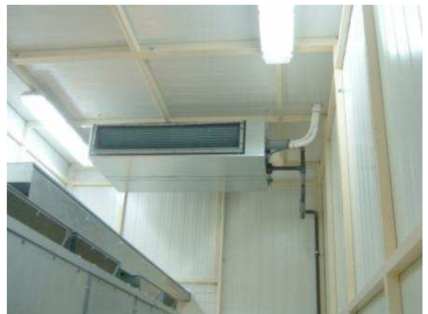
Climatizzare a soffitto nelle sale di protezione degli inverter
