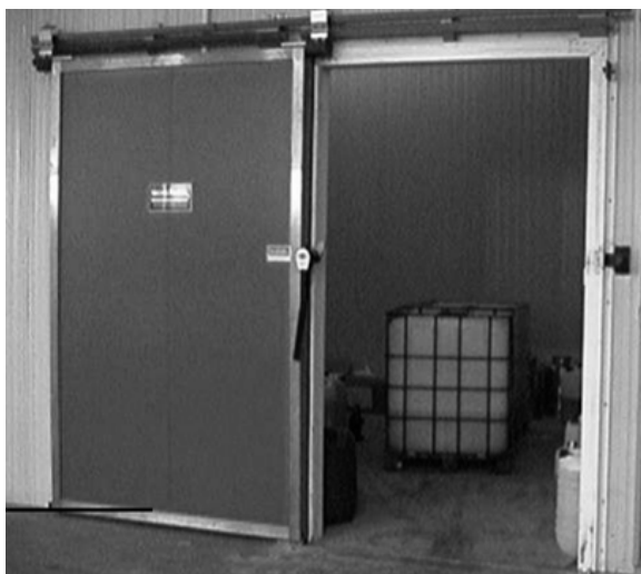
Figura 7: Cella frigorifera per il mantenimento dei prodotti alimentari
